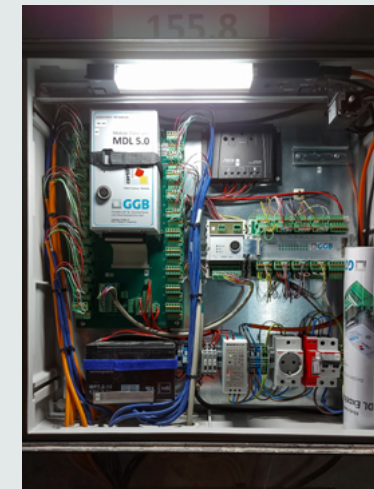
Misst schon seit Jahren im Tunnel Feuerbach: Ein Modularer Datenlogger MDL 5.0
